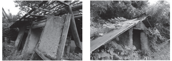
写真-4 現存する灰小屋（崩壊）
