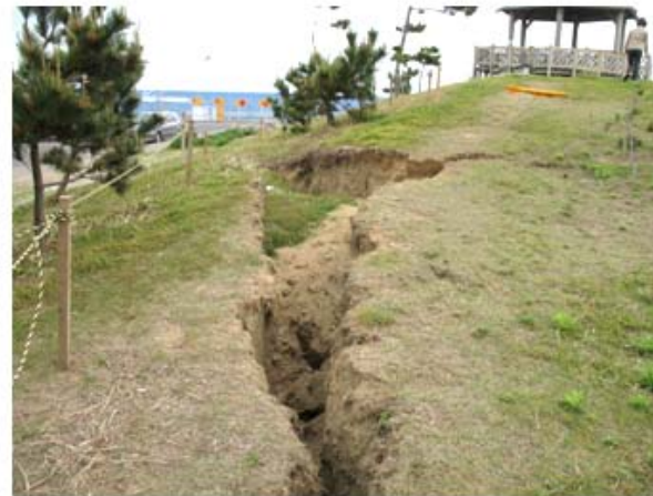
盛土した 築山の亀裂
