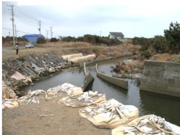
崩落したコンクリート護岸 大型土納で 応急措置
