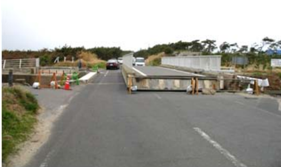
車道用橋梁 に乗り上げた 歩道用橋梁
