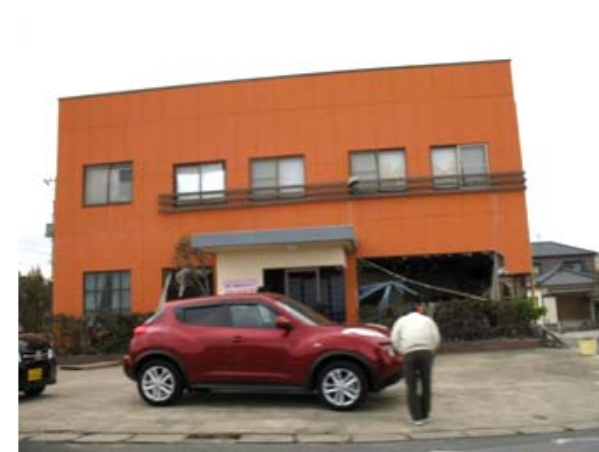
二階まで浸水した海岸沿いの建物
