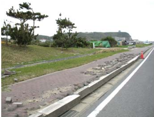
歩道のILB 舗装が崩壊
