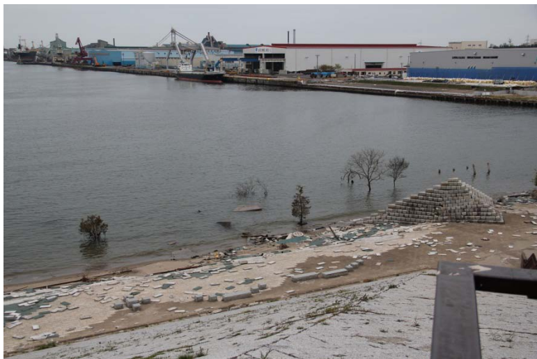
崩壊した護岸：中央公園
