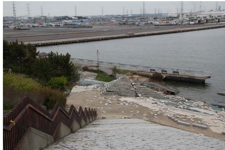
崩壊した護岸：中央公園
