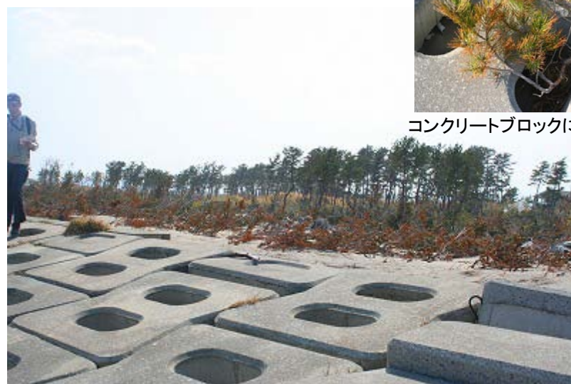
防潮堤がつぶれなかった場所はマツが残っている
