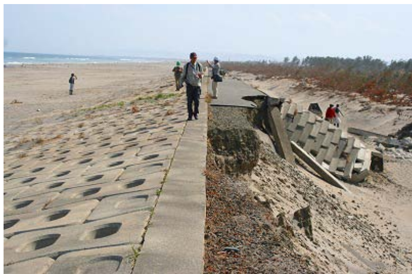
防潮堤の背面が大きく破壊される
