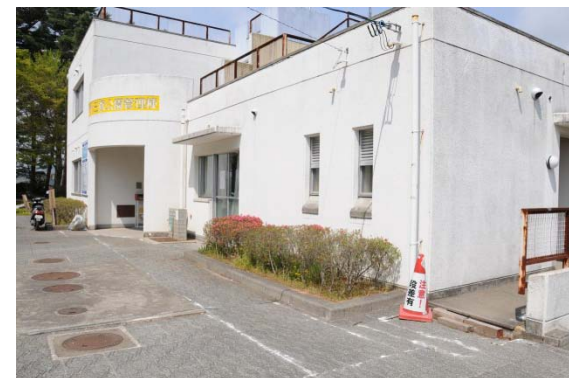
管理棟の周りの舗装に被害有り
