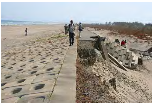
写真 -1 防潮堤被害
