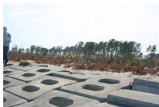
-3 残存した防潮堤の背後の松林
