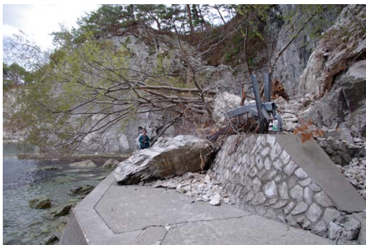
写真2:浄土ヶ浜 海食崖の崩落と遊歩道
