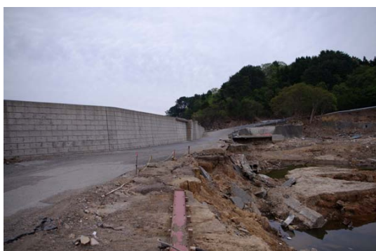
写真 6: 音部里地区 防潮堤は大きくは損壊していないが内部(右側)の被害は甚大
