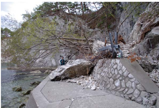
写真2:浄土ヶ浜 海食崖の崩落と遊歩道
