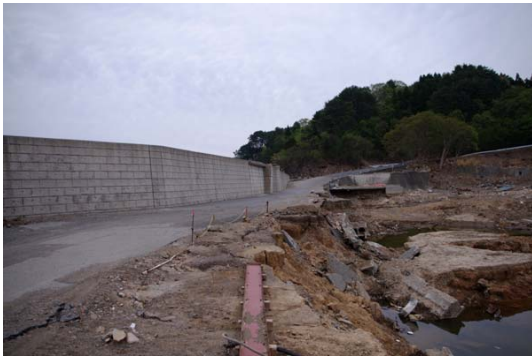
写真 6: 音部里地区 防潮堤は大きく損壊して いないが内部(右側)の被害は甚大
