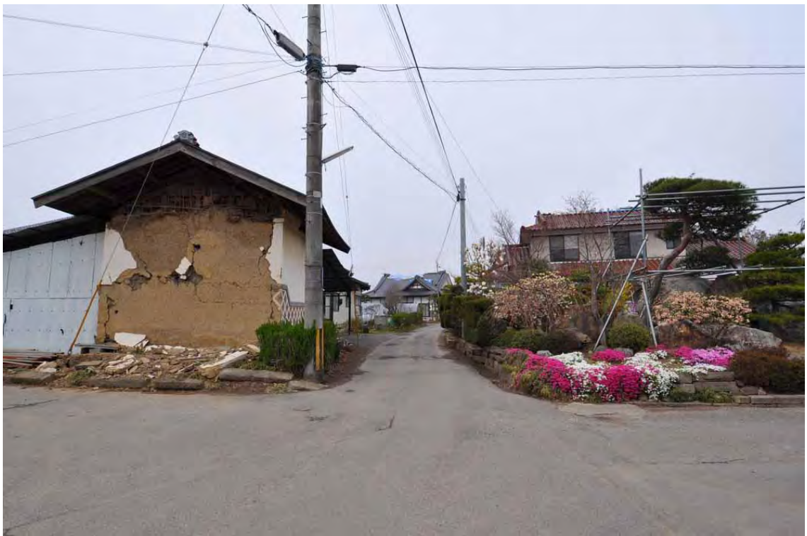
10 被災した土蔵、家屋の屋根
