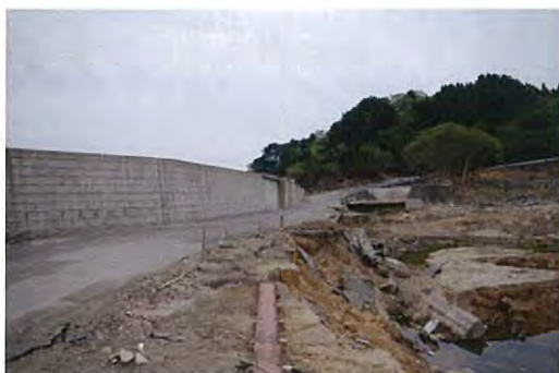
写真 6: 音部里地区 防潮堤は大きくは損壊していないが内部(右側)の被害は甚大
